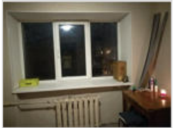
Фото 10. Жилая (помещение №1 по плану БТИ), батарея отопления
