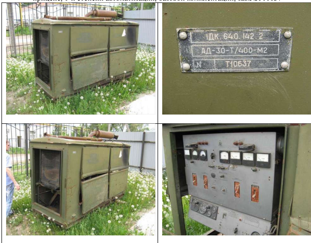
Дизельная электростанция марки АД-30-Т400-1РКГ с консервации под капотом на одноосном прицепе, 1-й степени автоматизации, базовой комплектации, зав.№Т10637
